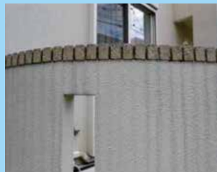
外部塀に発生した雨垂れ
