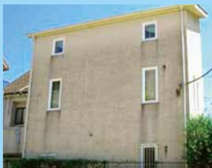
外壁に発生した黒カビ
