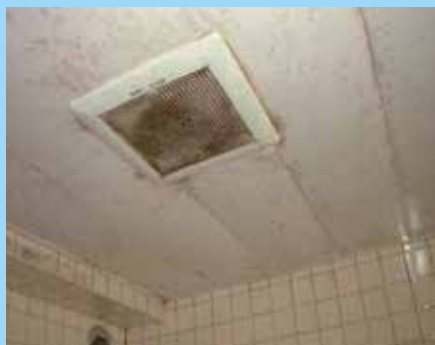
浴室に発生したカビ
