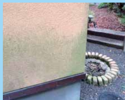
外壁に発生した藻(北・東面に多発)
