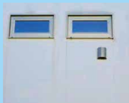
サッシ両端に発生した雨垂れ
