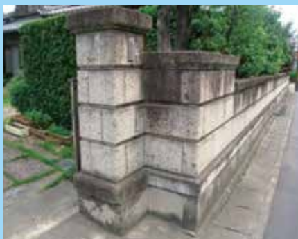
外構塀に発生した雨垂れ
