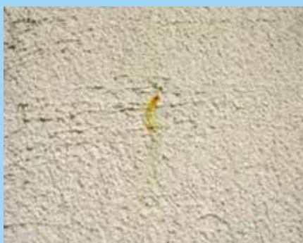
外壁材に混入した鉄粉から発生したサビ垂れ
