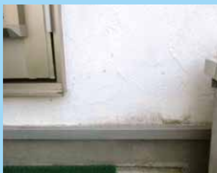
土台水切り上部に発生した黒カビ
