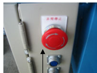
非常停止ボタン
